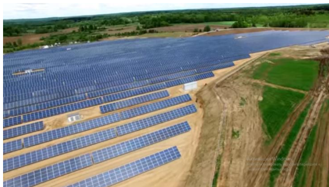
Рис. 2. – Солнечная электростанция ЗАО «Модус Проджектс», Мядель
